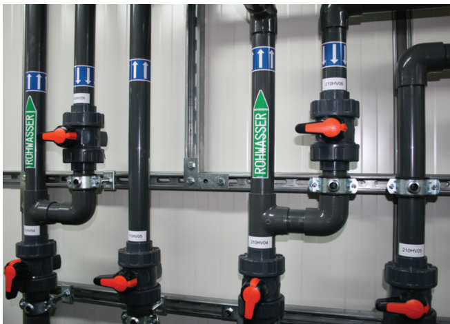
Abbildung 2: Kennzeichnungen von Betriebswasserleitungen (Quelle: MULTI-ReUse)
